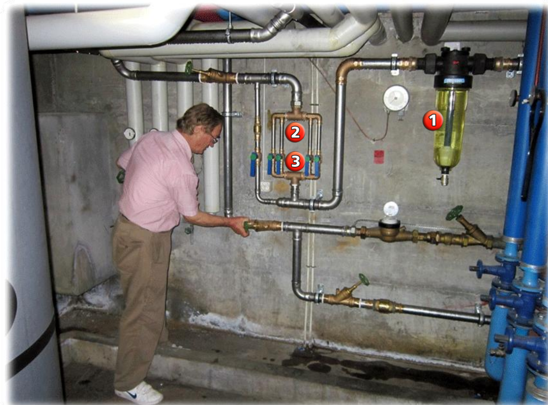
Instalación en un inmueble de 35 apartamentos
